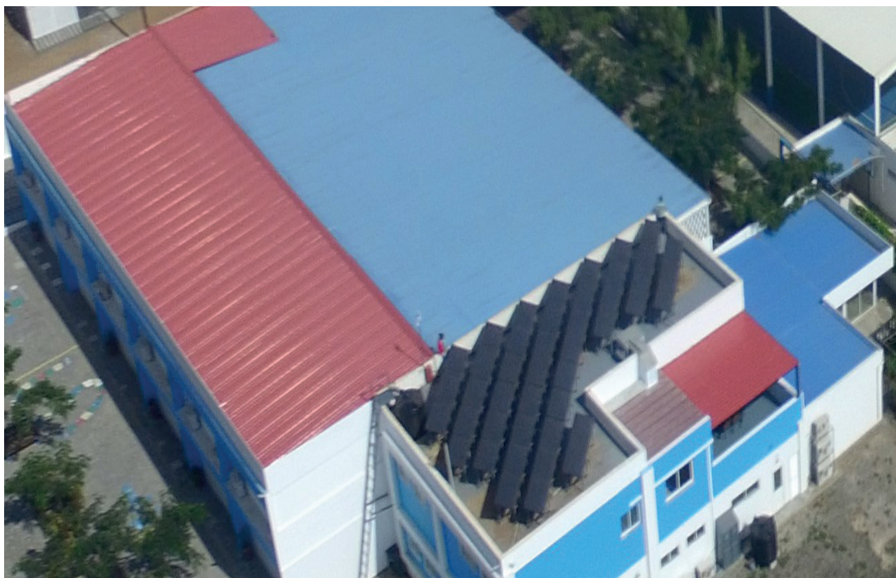
Painéis fotovoltaicos (pavilhão A)
